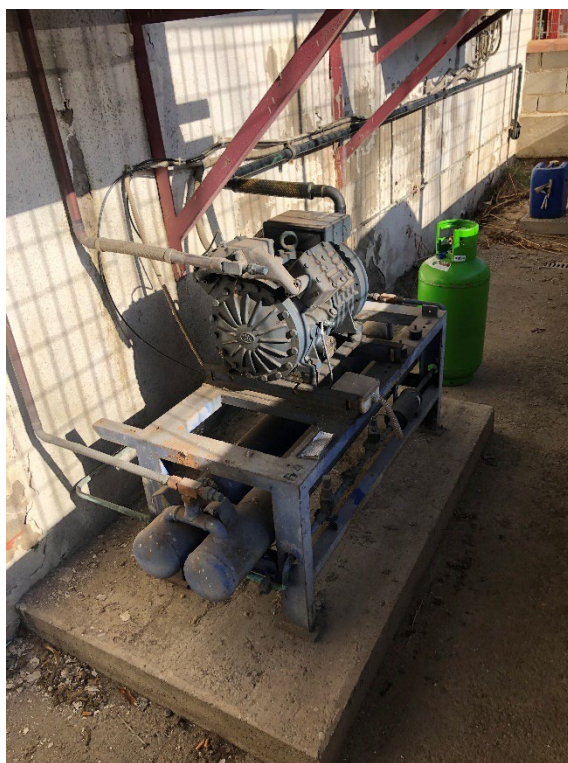
Figura 28 CASA TOSCANA; compressore impianto frigorifero autonomo
