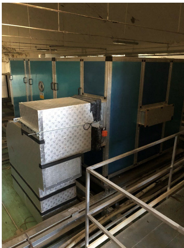
Figura 27 CASA TOSCANA; UTA locale lavorazione salami
