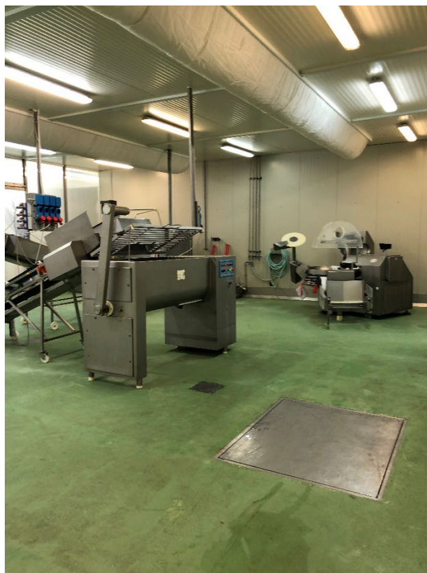
Figura 25 CASA TOSCANA; locale "Lavorazione" impianto di condizionamento canali di distribuzione dell'aria
